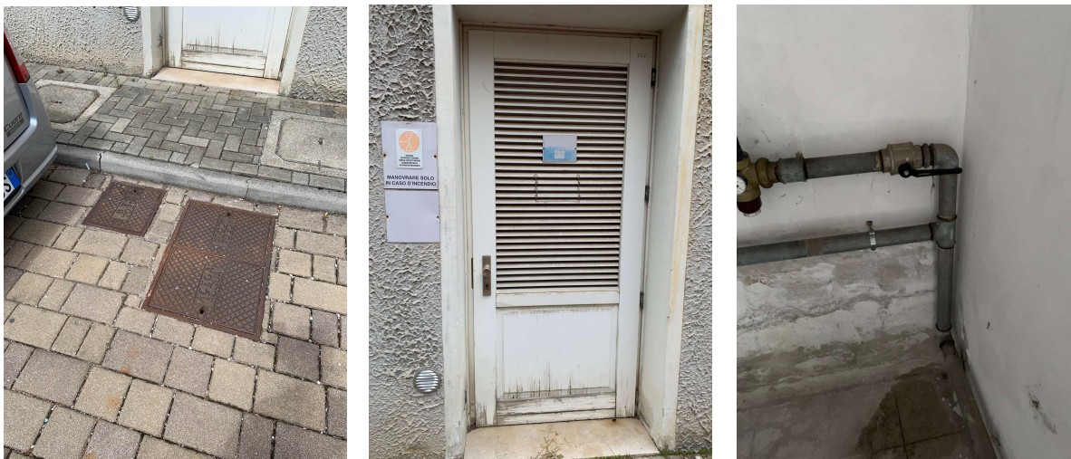
Foto 12: Vista del pozzetto sottosuolo e del locale contatore gas contenete la valvola di intercettazione dell'erogazione dell'acqua
