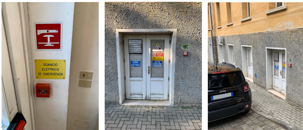
Foto 11: Vista del pulsante di sgancio elettrico presente all'interno dell'edificio in corrispondenza della portineria e porta di accesso della cabina elettrica di media tensione con affaccio su via Weiss
