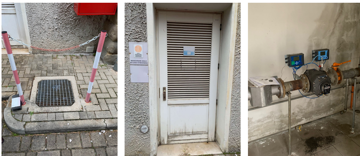
Foto 10: Vista del pozzetto contenente la valvola di intercettazione generale del gas e locale in cui è presente la valvola di intercettazione del gas metano a servizio per la C.T.
