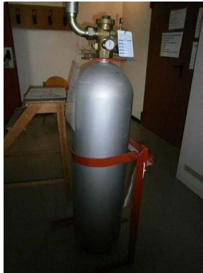
Foto 22: Vista del bombolone dell'impianto di spegnimento ad attivazione manuale per l'aula computer
