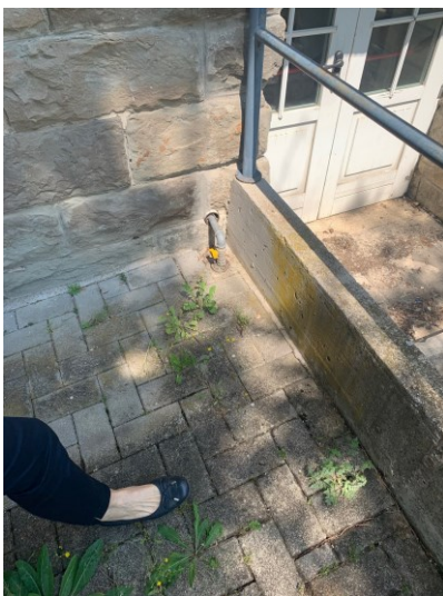
Foto 23: Vista della valvola generale di intercettazione del gas metano
