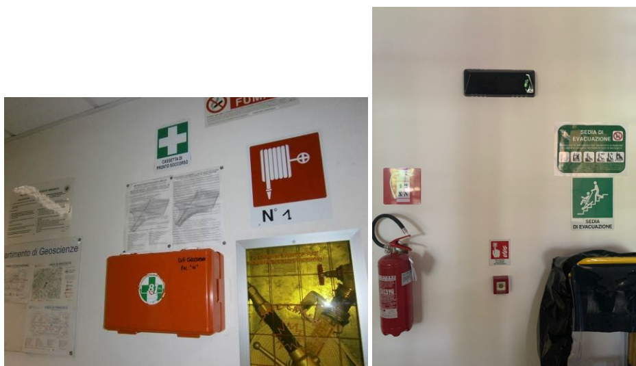
Foto 16: Vista dei presidi di emergenza presenti nei corridoi
