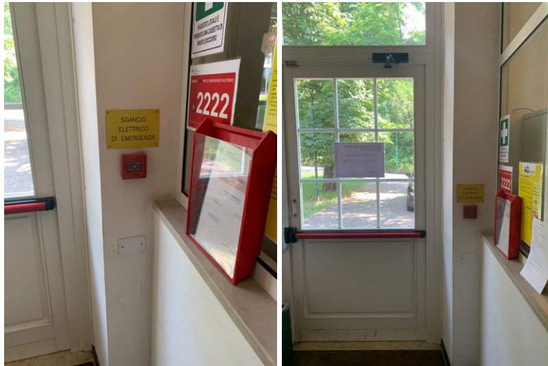
Foto 24: Vista dei pulsanti di sgancio generali dell'edificio, per la disattivazione dell'erogazione delle rete elettrica
