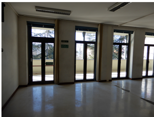
Foto 16: Vista delle porte di emergenza che si affacciano sul ballatoio
